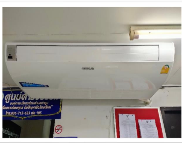
เครื่องปรับอากาศสำนักงาน
