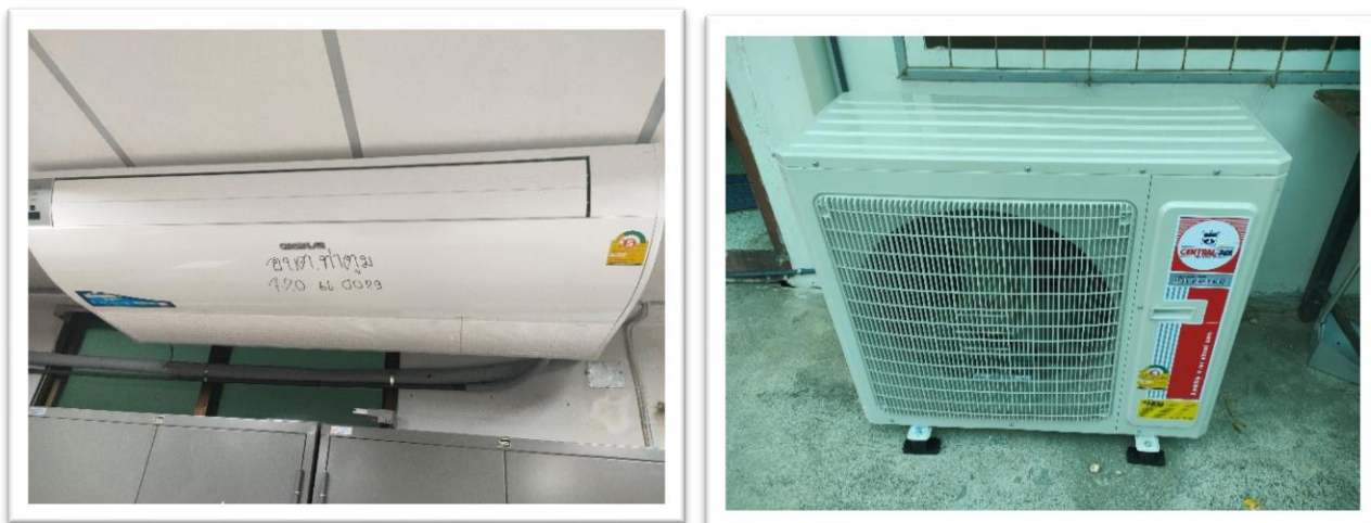
เครื่องปรับอากาศสำนักงาน
