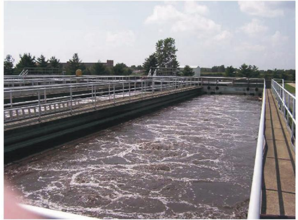
บ่อบำบัดน้ำเสีย
