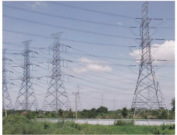
เสาไฟฟ้า
