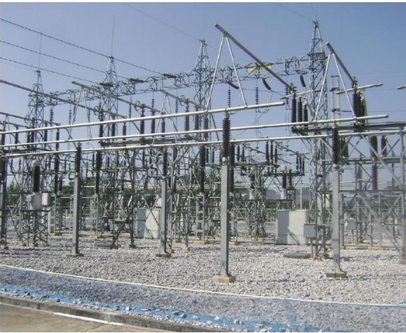
สถานไฟฟ้า
